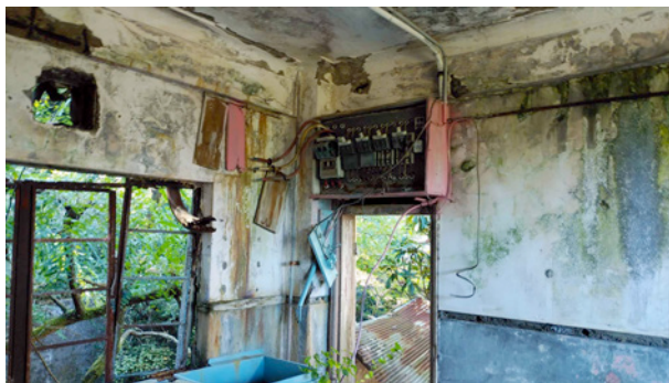
写真3 厨房の分電盤(撮影：寺島俊之)
