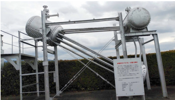
写真3 水管式HL-小型三胴式ボイラ (撮影：寺島俊之)
