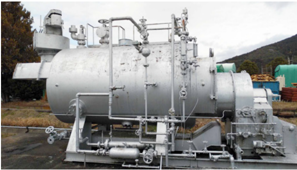
写真2 宮内庁向け炉筒煙管式ボイラ (撮影：寺島俊之)
